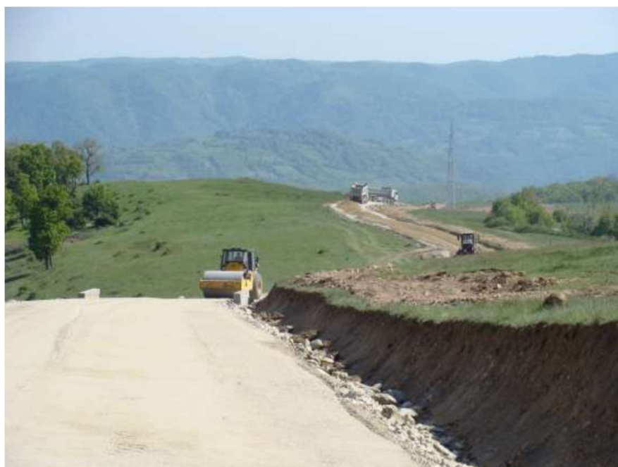
Fig. 8 Lucrări de amenajare a unui drum tehnologic pentru un parc eolian Se observă structura convexă a profilului transversal și modalitatea de construire a rigolelor cu anrocamente în scopul atenuării forței erozive a apelor pluviale
