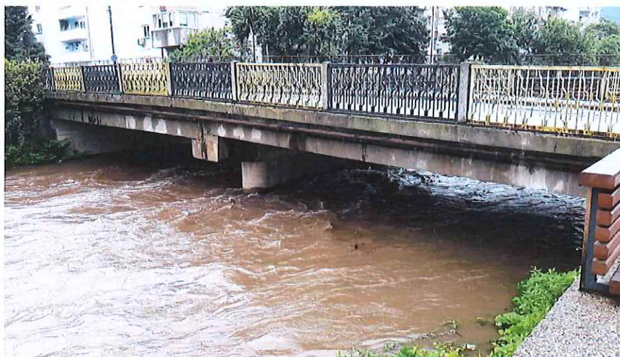
După ploaia torențială din iunie 2023 – aval
