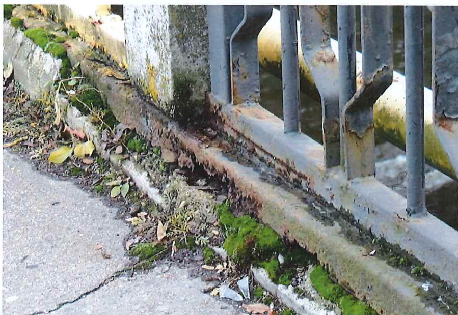
Degradări la parapetul pietonal
