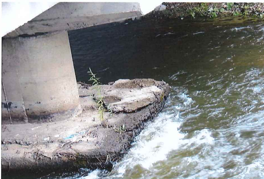
Degradări la pilă
