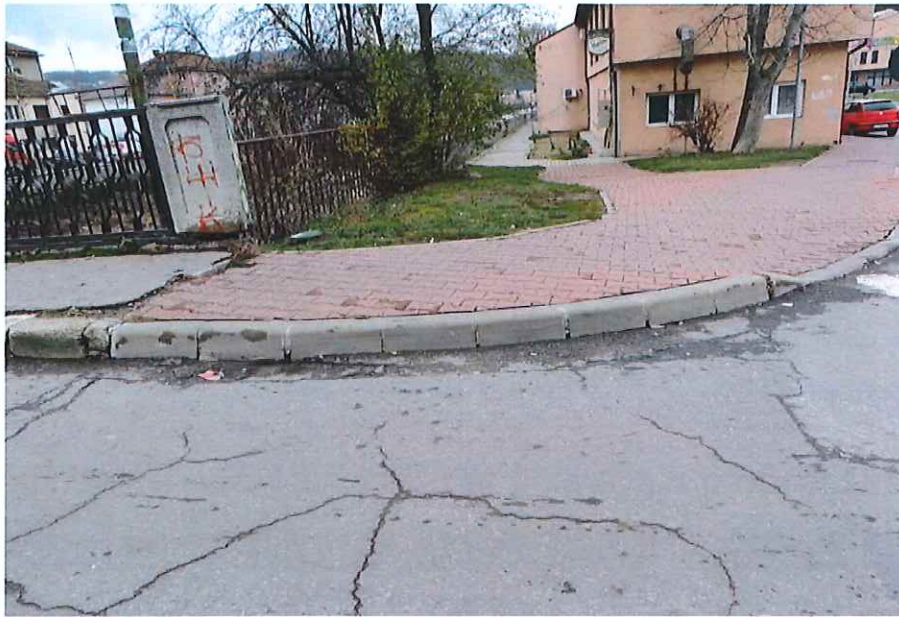
Degradări la partea carosabilă
