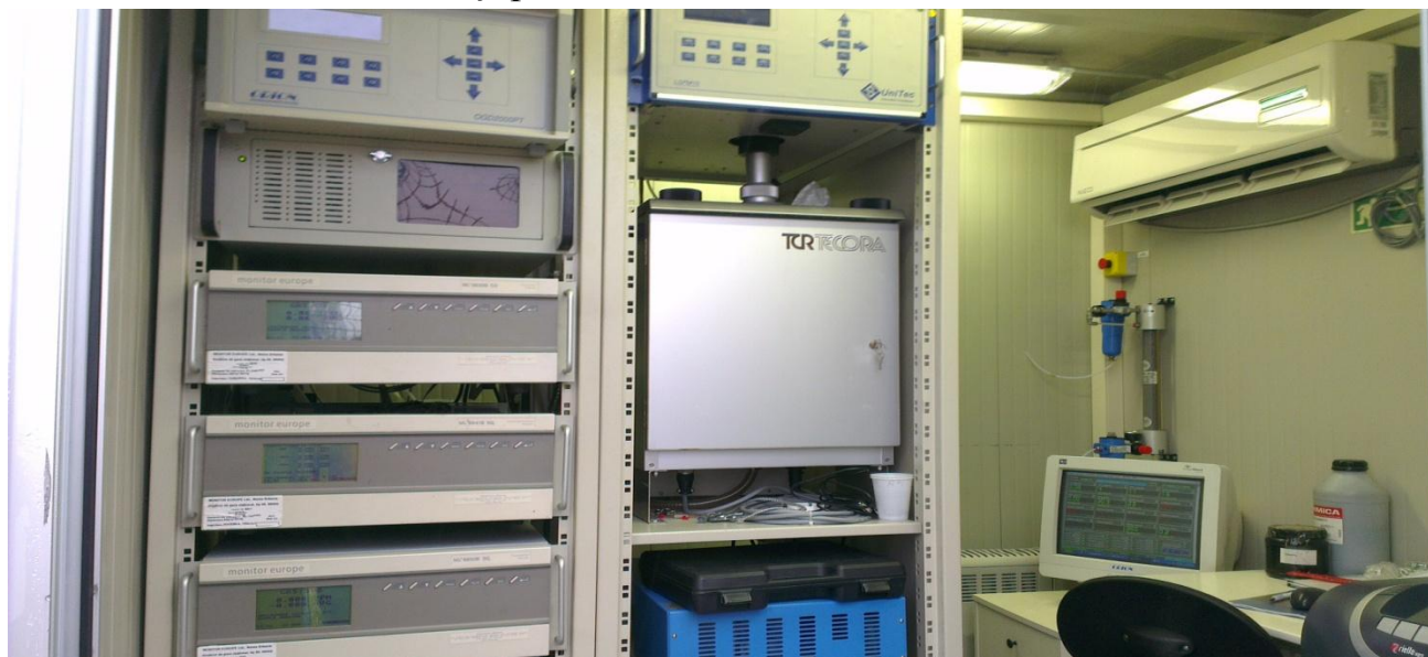
Figura 2.3 Interior stație de monitorizare a calității aerului în județul Covasna auxiliare;
