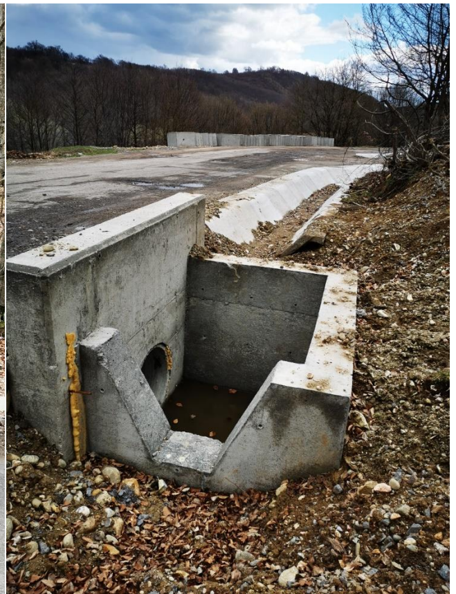
Figura 11. Rețea de colectare și dirijare a apelor pluviale executat pe marginea DJ131
