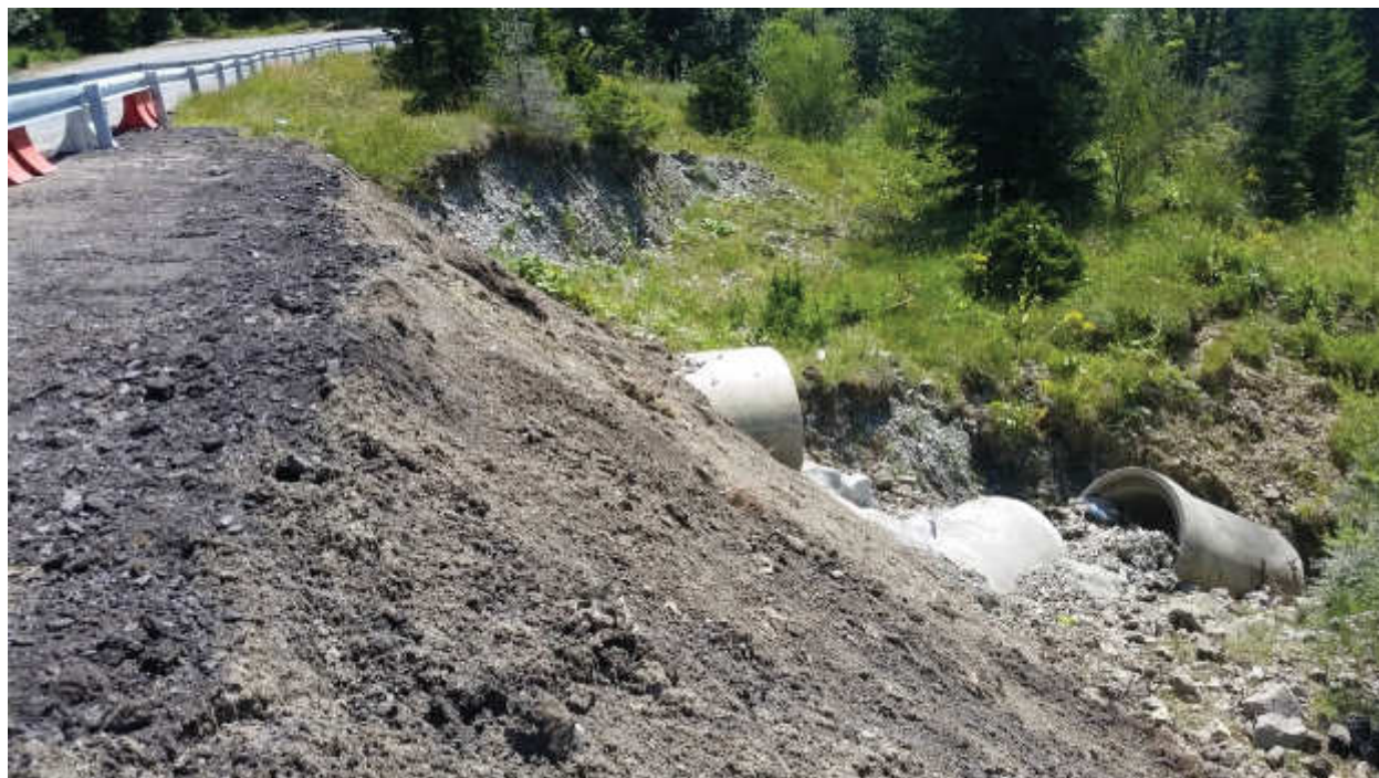
Figura 31 – Încercarea de stabilizare a taluzului DN 71 prin lărgirea acostamentului cu contraforturi de pământ și drenuri, lângă pajiștile habitatului 6440, în sudul Poienii Hoților.
