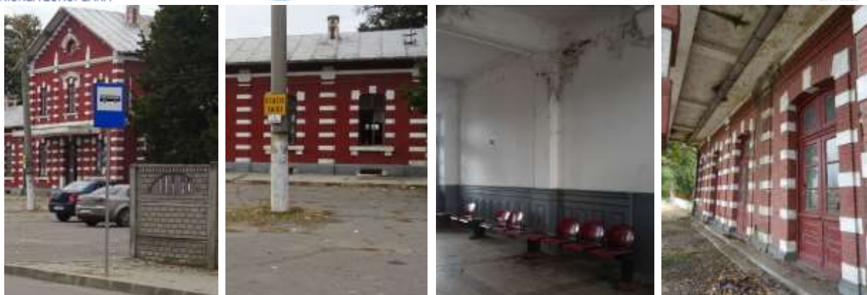
Fig. nr. 3.52 Aspecte din cadrul Stației CF Băilești și stațiilor de transport adiacente: a. stația de autobuz, b. stația de taxi, c, d, exemple de degradări la nivelul stației CF
