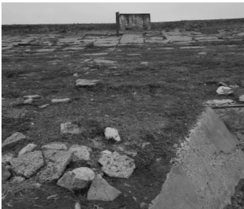
Figura 13 Imagine reprezentativa a nivelului de degradare a taluzului amonte (Sursa: Sursa: Raport Expertiza Tehnica, anul 2018)
