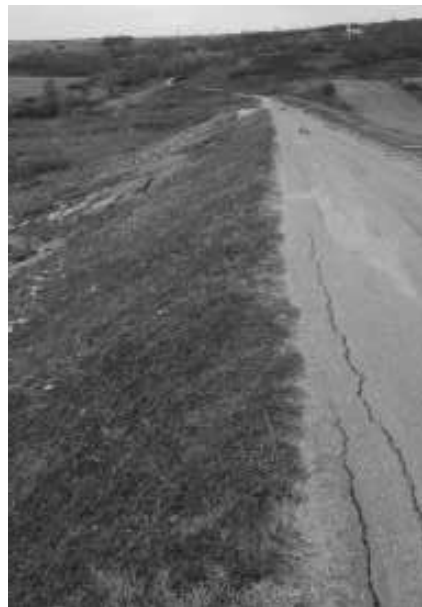
Figura 12 : Taluzul amonte pe care se pot observa fisuri si degradari ale dalelor de beton (Sursa: Raport Expertiza Tehnica, anul 2018)
