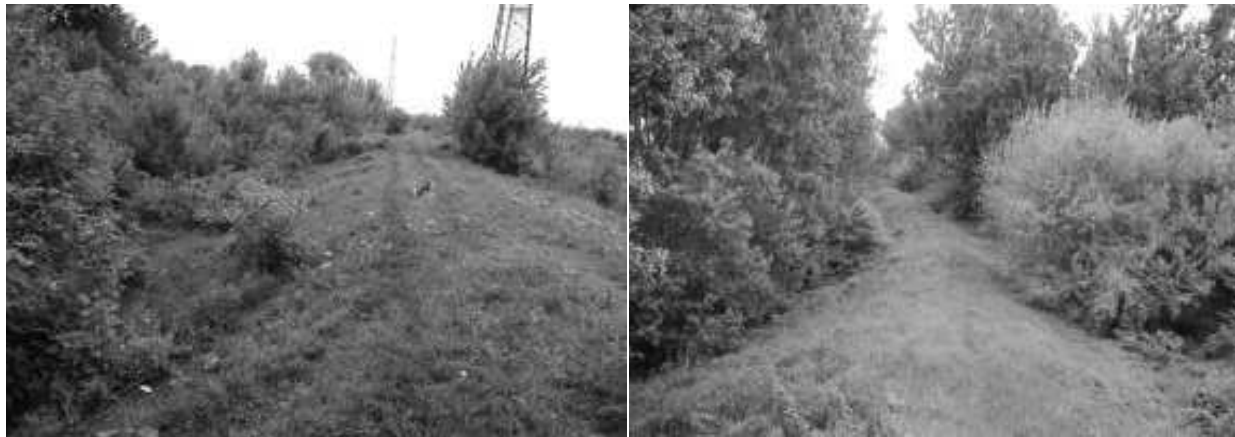
Figura 17: Denivelari ale coronamentului diguri, taluzuri deteriorate (Sursa: Raport Expertiza Tehnica, 2018)
