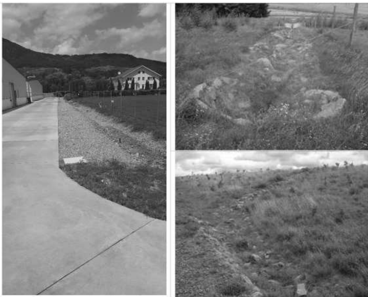
Figura 15. Soluții de realizare a unor rigole de preluare a apelor pluviale de la nivelul unor incinte industriale: stânga – rigolă parțial pietruită (Alesd); dreapta – rigole parțial pietruite (perimetru Wismut, Germania)
