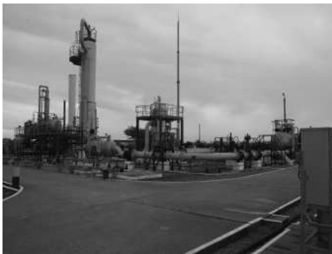
Instalații existente în incinta Stației Centrale Ghercești
