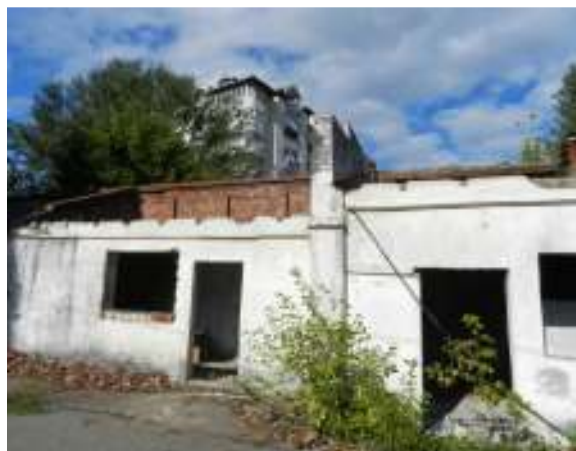
Deseuri materiale de constructie – cladire partial demolata
