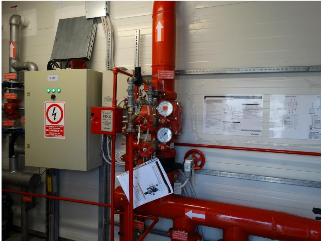
Foto nr.3 Instalatie pentru stingere incendiu
