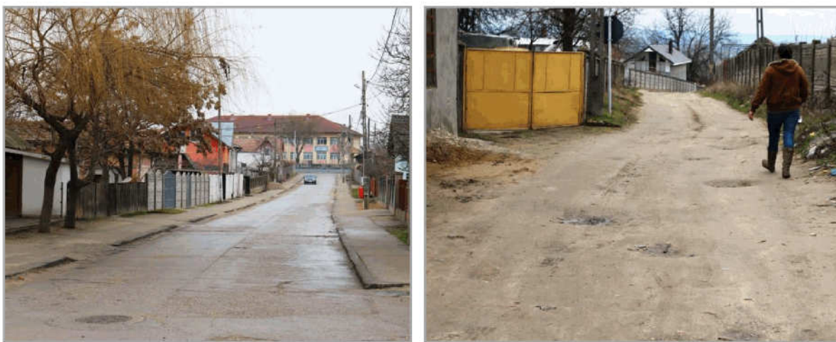
Figura 2.44. Trotuare cu grad ridicat de deteriorare (Exemplificare).
