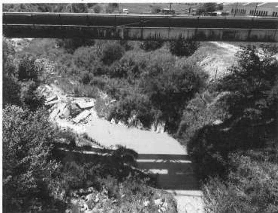
Foto III.1.2 -Lucrare existentă aval pod deteriorată
