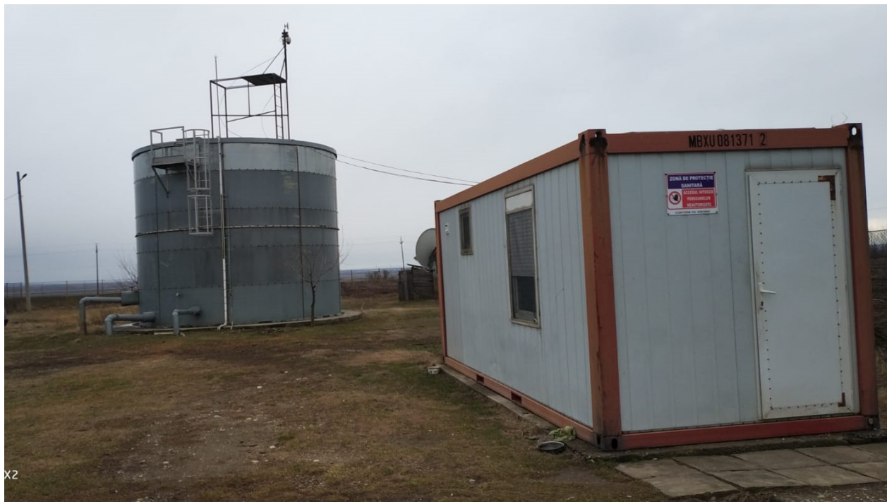
Foto1: Container existent in gospodaria de apa
