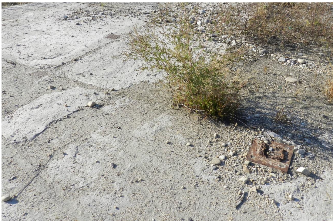
Fig. 3 – Platformă betonată existentă degradată cu vegetație crescută prin rosturile sale
