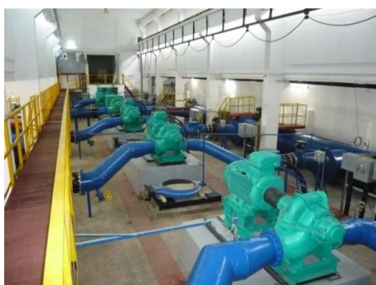
Uzina de apă nr.2- Sala pompelor (foto 2)
