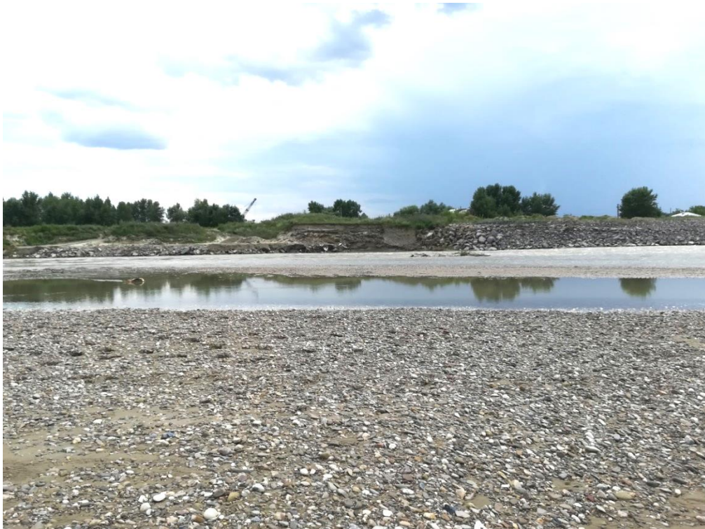
Fig. 26 Distrugere apărare mal Suraia
