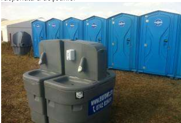
Model de soluție de asigurare a condițiilor de igienă pe amplasamente temporare cu un număr mare de lucrători: toalete ecologice, cu bazin etanș, vidanjabil, tratat chimic; lavoare de spălare cu rezervoare etanșe ce asigură apa de spălare ce este apoi re-introdusă în rezervor distinct, etanș, vidanjabil
