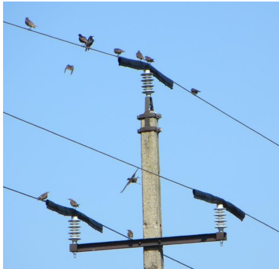
Figura I.112. Exemplu de montare de teци electroizolante ( https://www.e-distributie.com/ro/stiri/2019/08/Mai-multa-siguranta-pentru-berze-in-reteaua-electrica-E-Distributie.html )
