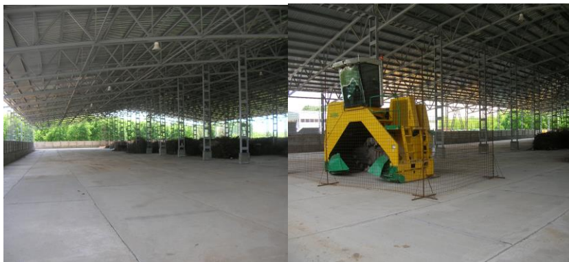
Stația de compostare Galați
