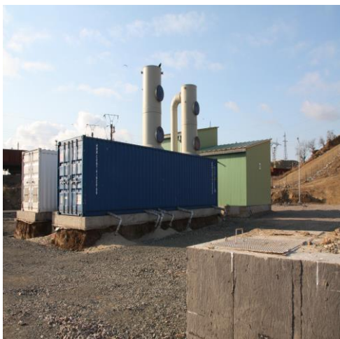
Stia de epurare levigat a Depozitului ecologic Tirighina Galați
