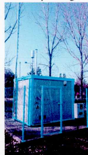
Stație de monitorizare
