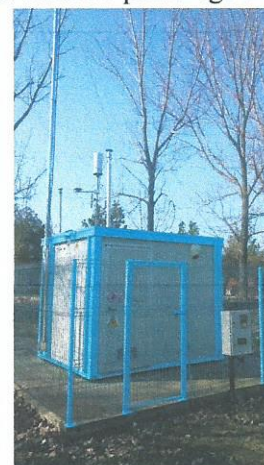
Stație de monitorizare
