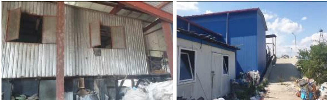
Figura 4.10. Stația de transfer și sortare C rbune ti
