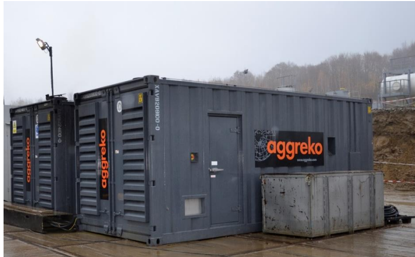
Figura nr. III-5 Generatoarele electrice ce urmează a fi folosite în cadrul proiectului, amplasate pe una din locațiile Amromco
