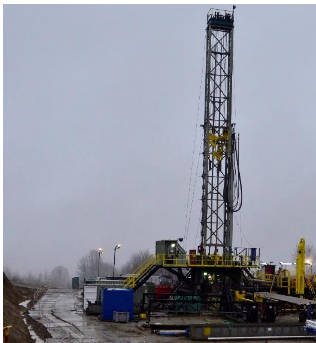
Figura nr. III-1 Model de instalație de foraj amplasată pe una din locațiile Amromco Energy SRL
