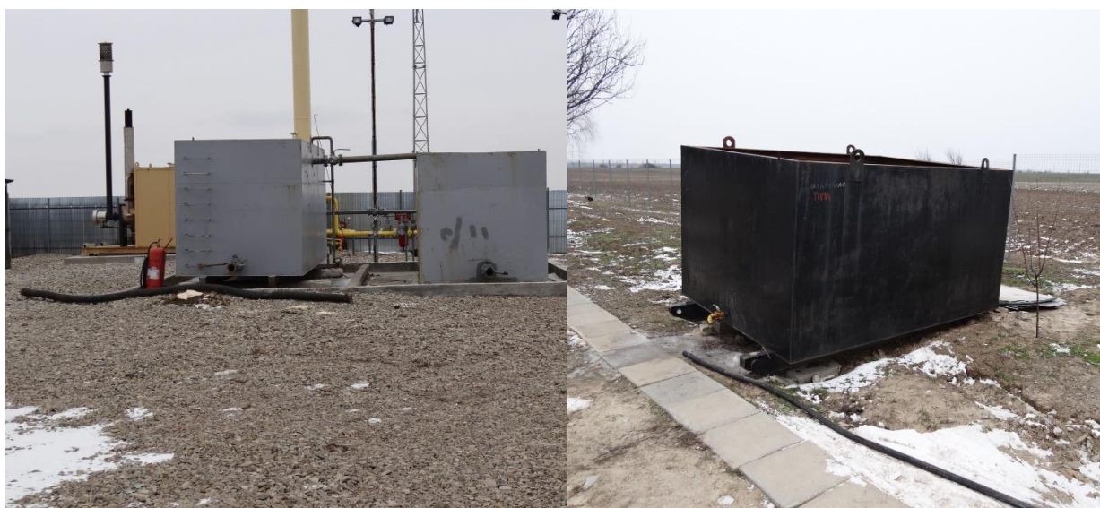
Figura nr. III-3 Model de habă de apă amplasată pe una din locațiile Amromco Energy
