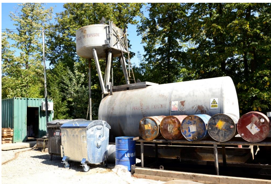
Figura nr. III-4 Rezervor de motorină amplasat pe una din locațiile Amromco Energy
