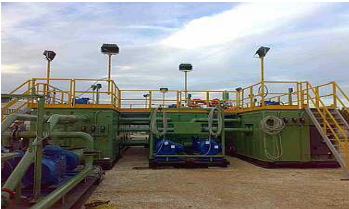
Sistemul de depozitare a fluidului de foraj la sonda
