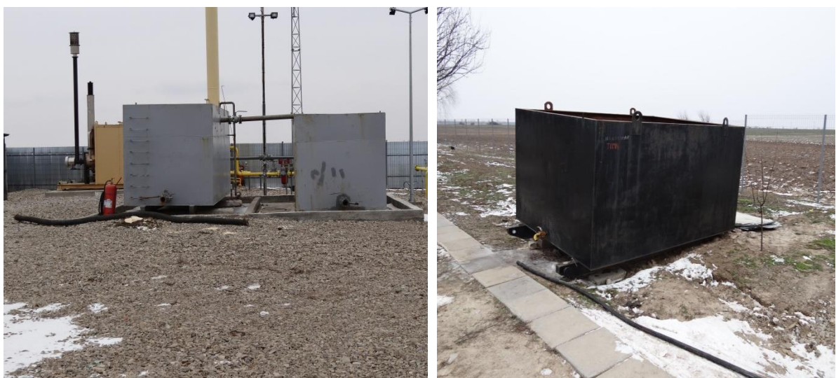
Figura nr. 2-5 Model de habă de apă amplasată pe una din locațiile Amromco Energy SRL
