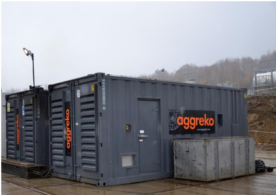
Figura nr. 2-7 Generatoarele electrice ce urmează a fi folosite în cadrul proiectului, amplasate pe una dintre locațiile Amromco
