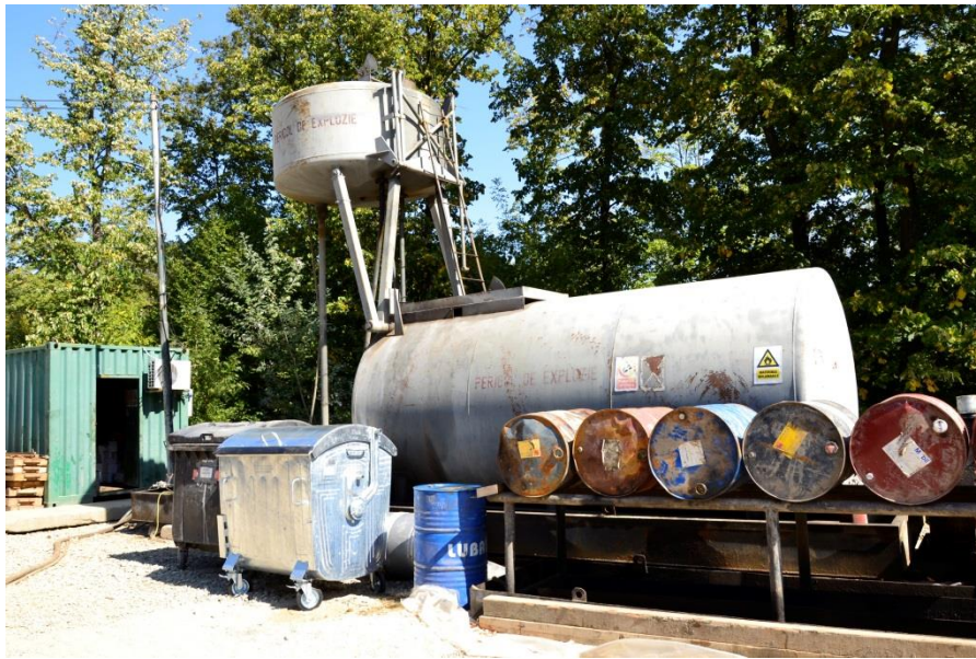
Figura nr. 2-6 Rezervor de motorină amplasat pe una din locațiile Amromco Energy SRL
