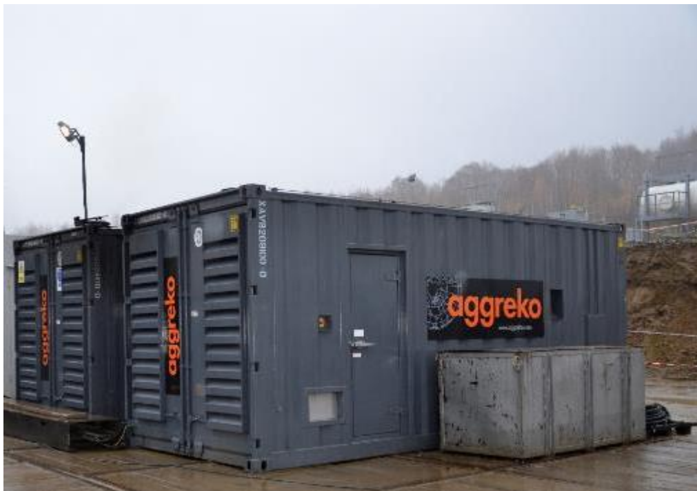
Figura nr. 1-5 Generatoarele electrice ce urmează a fi folosite în cadrul proiectului, amplasate pe una din locațiile Amromco S.R.L
