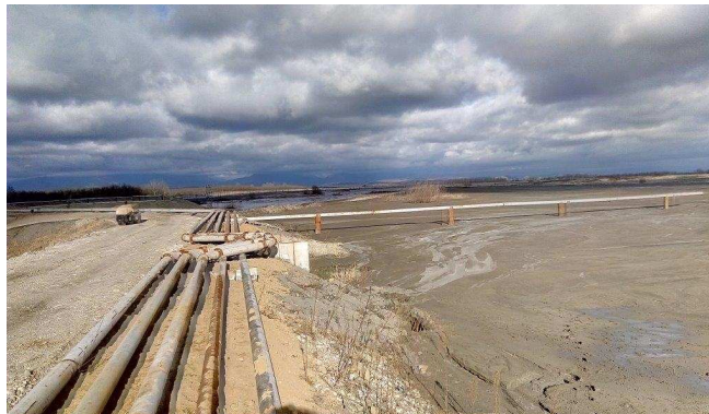
Fig 4.4.1 Conducte de transport și deșurare șlam dens autoîntăritor
