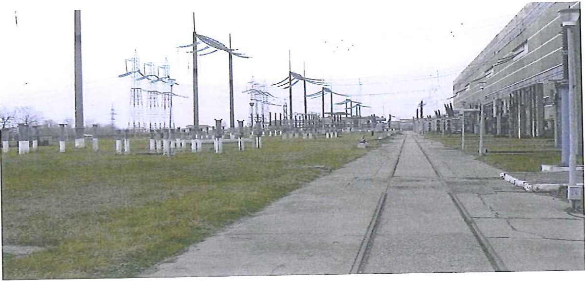
F1 Stația electrică exterioară
