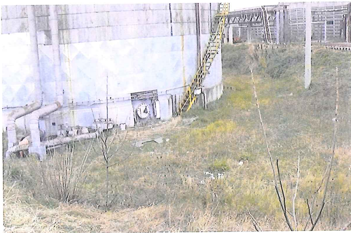
R2 – Rezervor păcură
