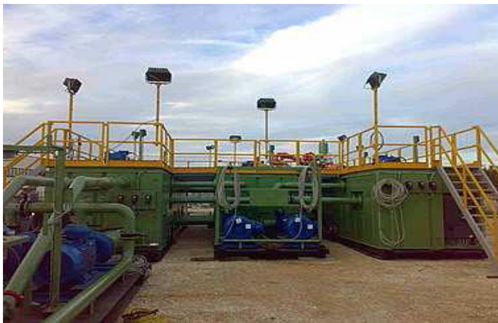
Sistemul de depozitare a fluidului de foraj la sonda
