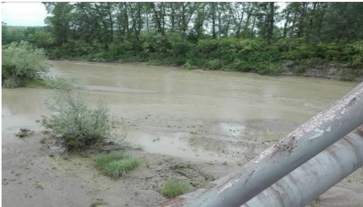
Figura nr 2.1.1-3. Zona amonte traversare aeriana, afectata de eroziune, mal stang raul Arges
