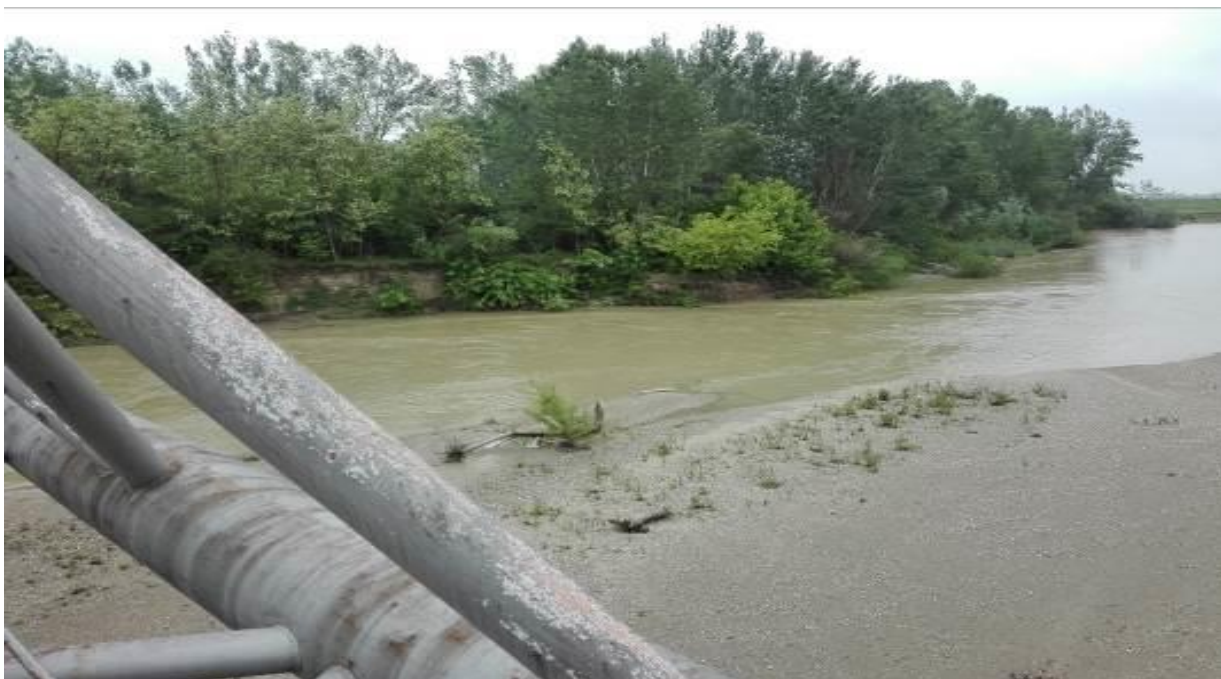
Figura nr. 2.1.1-4. Zona aval traversare aeriana, afectata de eroziune, mal stang raul Arges
