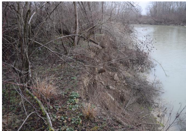
Foto5: Zona mal degradat, unde se va interveni pentru consolidare UAT Gaiseni, judetul Giurgiu
