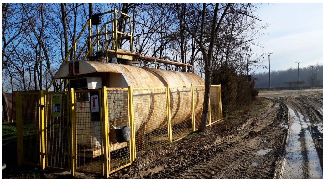
modul de alimentare combustibil zona stație sortare
