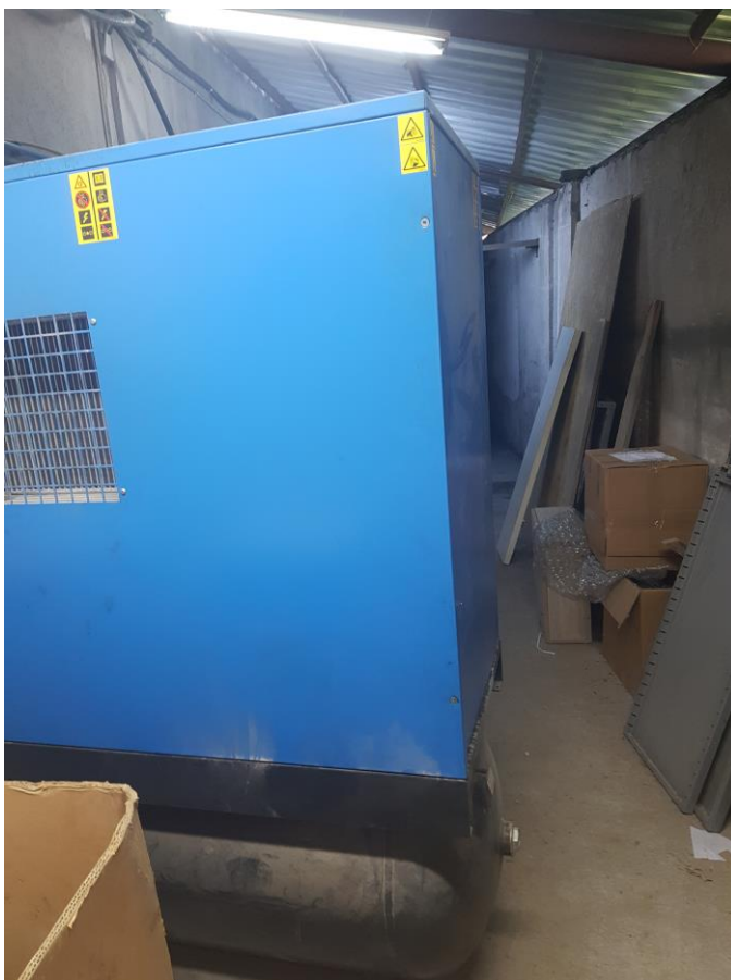
Fig. 4.2.1. - Compresor, Butelie aer comprimat
