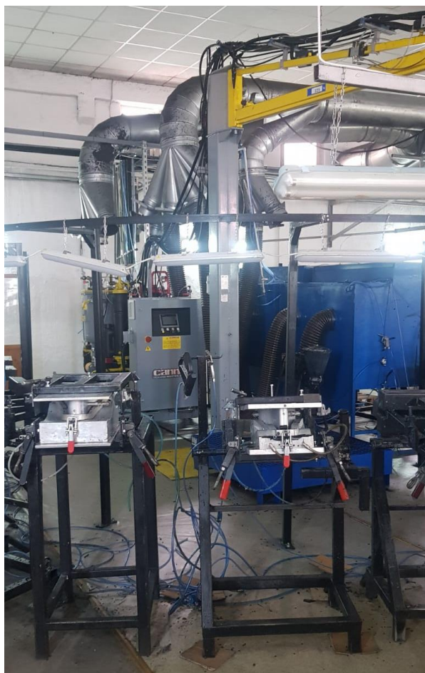
Figura 11. Instalații turnare componente (scaune bicicleta), prin injecție în matriță, prevăzute cu instalații de exhaustare a vaporilor echipate cu hote de aspirație și 2 bucăți ventilatoare cu debitul total de 52000 mc/h care refulează prin 2 coșuri cu înălțimea de 6 m și diametrul de 0,8 m
