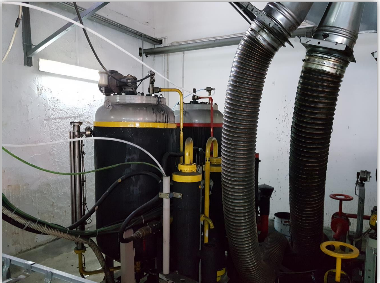
Figura 10. Sursa Alimentare Secția de turnare componente (scaune pentru bicicleta) FABRI S.R.L.
