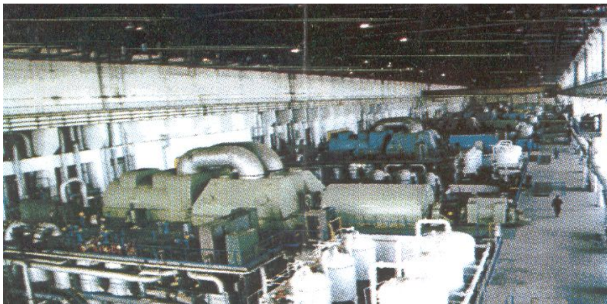
SALA MAȘINILOR (TURBINELOR)
