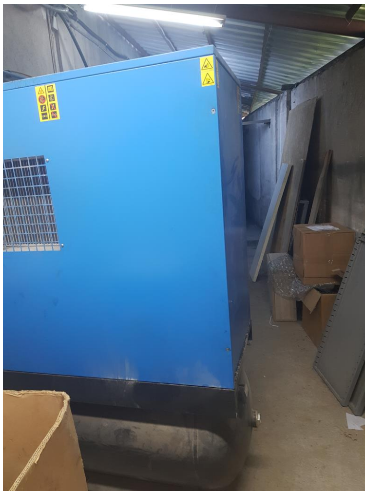
Fig. 2.3.1. - Compresor, Butelie aer comprimat
