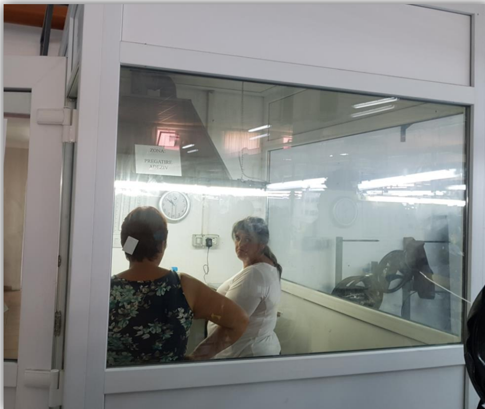
Fig. 2.3.9. – Zona de preparare adeziv prevăzută cu instalație de captare și exhaustare a vaporilor de solvenți echipată cu 1 ventilator cu debitul de 12000 mc/h care refulează printr-un cu coș diametrul de 0,40 m
