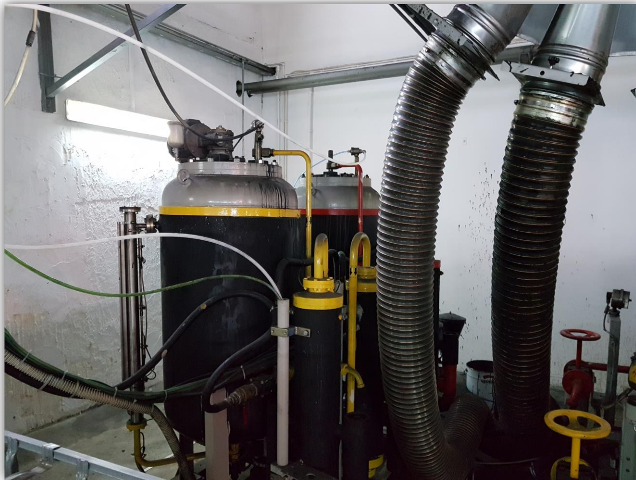
Fig. 2.3.5. – Sursa Alimentare Secția de turnare componente auto și scaune pentru bicicleta FABRI S.R.L.
