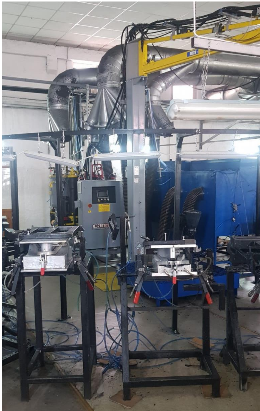
Figura 14. Instalații turnare componente (scaune bicicleta), prin injecție în matriță, prevăzute cu instalații de exhaustare a vaporilor echipate cu hote de aspirație și 2 bucăți ventilatoare cu debitul total de 52000 mc/h care refulază prin 2 coșuri cu înălțimea de 6 m și diametrul de 0,8 m Secția îmbrăcat componente auto în piele
