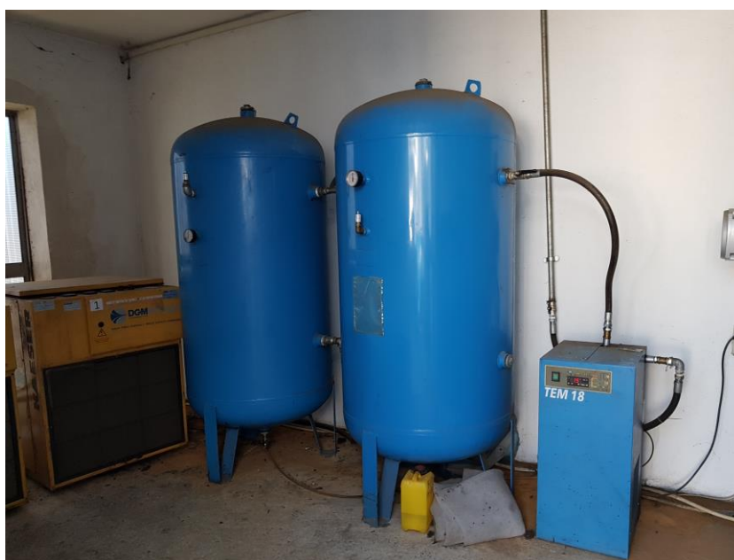
Figura 9. Compresor, Butelii de aer comprimat pentru curățarea mașinilor de injecție
