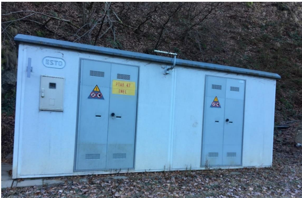
Fig. 11 Detaliu compartiment de racordare (partea stângă compartimentul ENEL DISTRIBUȚIE BANAT S.A., iar în partea dreaptă compartimentul producătorului)
