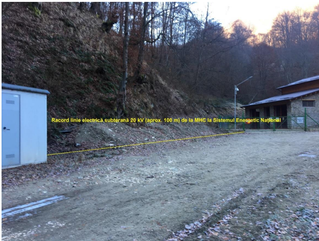
Fig. 10 Racord linie electrică subterană 20 kV (aprox. 100 m) de la MHC la Sistemul Energetic Național
