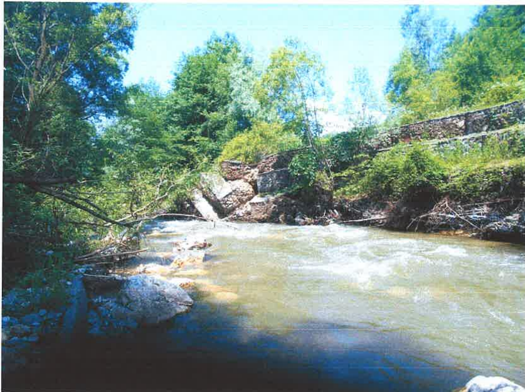
Foto 4 – râu Strei, apărare de mal drept din gabioane deteriorată în zona 4
