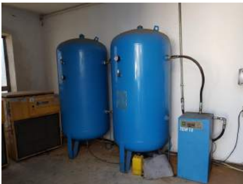
Figura 7. Compresor, Butelii de aer comprimat pentru curățarea mașinilor de injecție
