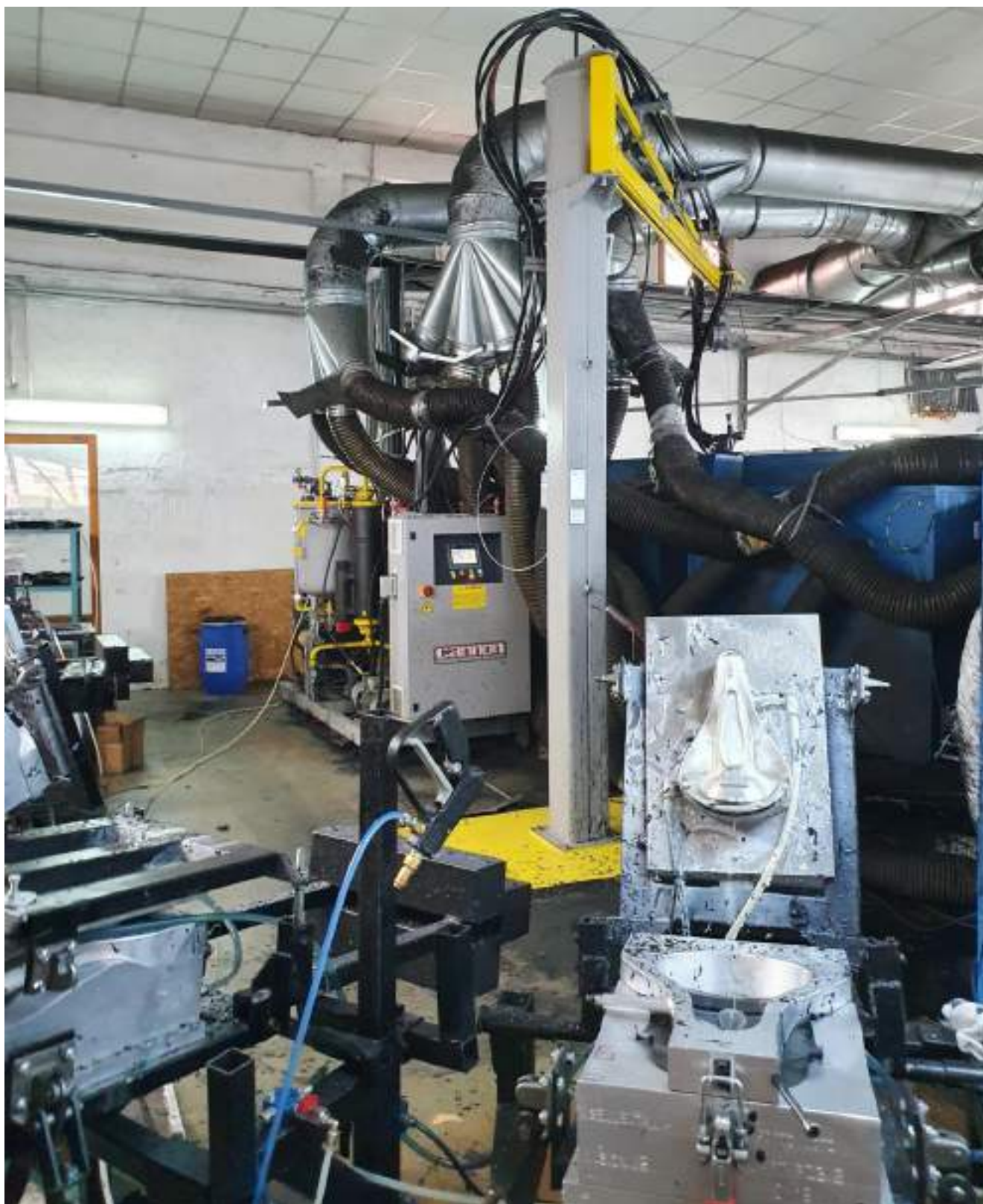
Figura 11. Instalații turnare componente (scaune bicicleta), prin injecție în matriță, prevăzute cu instalații de exhaustare a vaporilor echipate cu hote de aspirație și 2 bucăți ventilatoare cu debitul total de 52000 mc/h care refulează prin 2 coșuri cu înălțimea de 6 m și diametrul de 0,8 m
