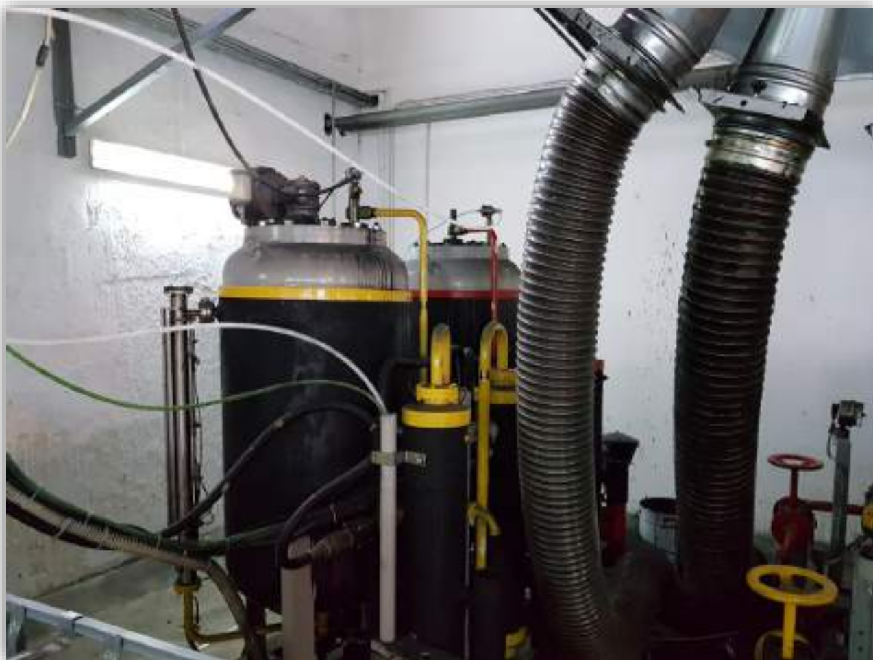
Figura 12.Sursa Alimentare Secția de turnare componente (scaune pentru bicicleta) FABRI S.R.L.
