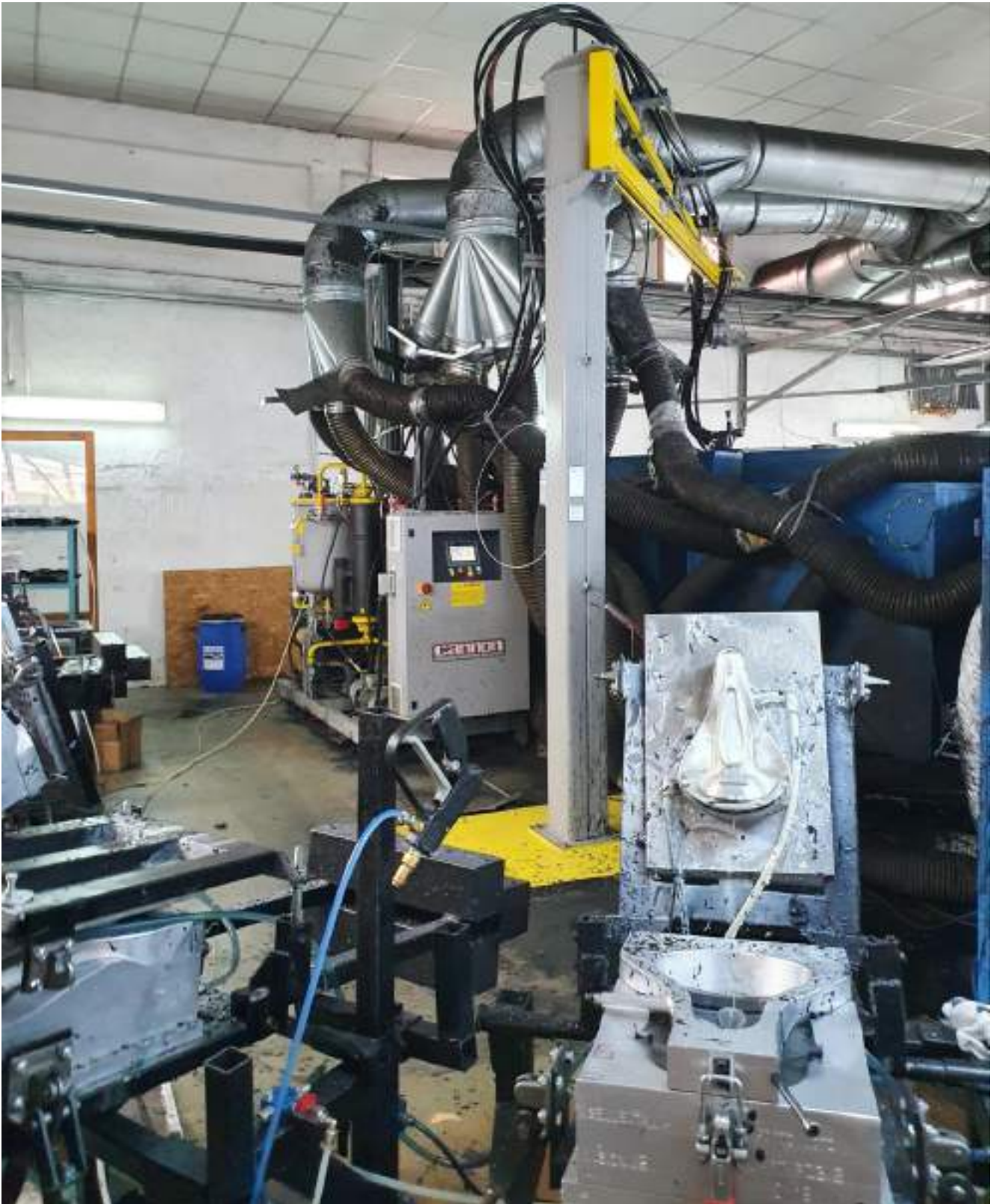
Figura 13. Instalații turnare componente (scaune bicicleta), prin injecție în matriță, prevăzute cu instalații de exhaustare a vaporilor echipate cu hote de aspirație și 2 bucăți ventilatoare cu debitul total de 52000 mc/h care refulează prin 2 coșuri cu înălțimea de 6 m și diametrul de 0,8 m
