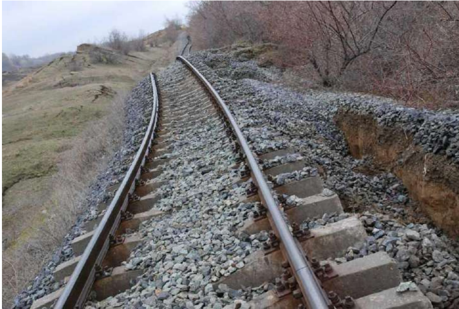
Foto XV.34. Impactul unei alunecări de teren asupra unei căi ferate (Sursa: adevarul.ro)
