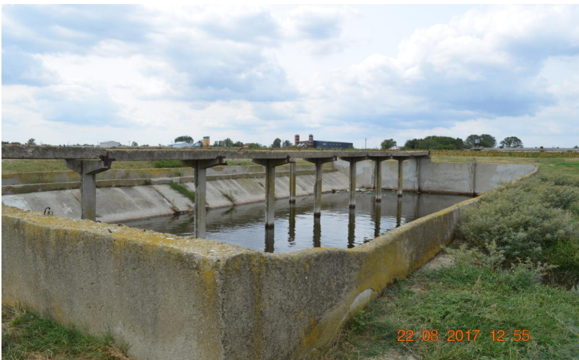
Foto 4b Bazin din sistemul instalatiei de preepurare
