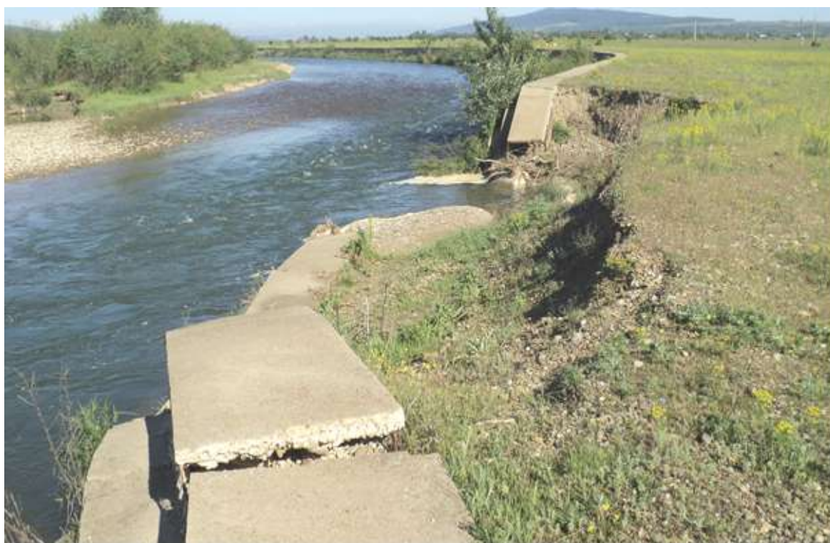
Foto - Râul Trotuș - aparare de mal din gabioane deteriorata cca. 60 m amonte de traversarea râului Trotuș cu conducta de transport titei Baraganu - Onesti
