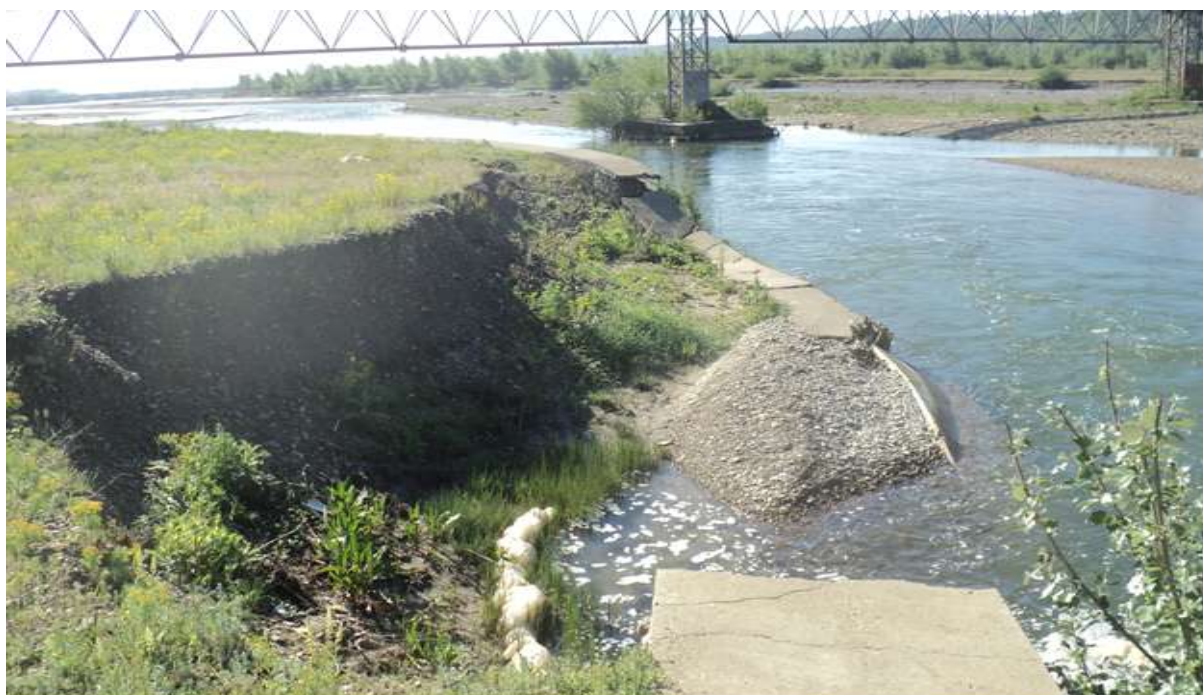
Foto - Râul Trotuș - aparare de mal din gabioane deteriorata cca. 60 m amonte de traversarea raului Trotus cu conducta de transport titei Baraganu – Onesti. Se observa structura solului pe latimea de cca. 15 m. de la mal, unde stratul de sol este aproape inexistent
