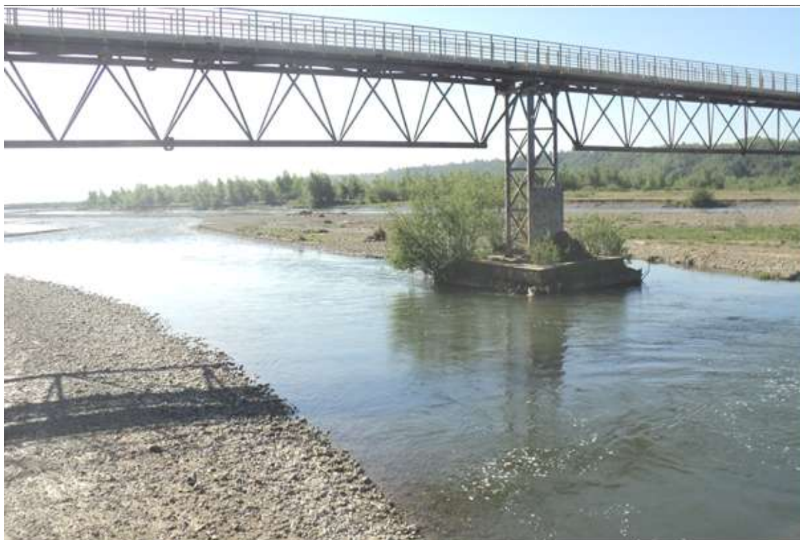
Foto - Raul Trotuș - Pila nr. 2 - consolidare pila, deteriorata
