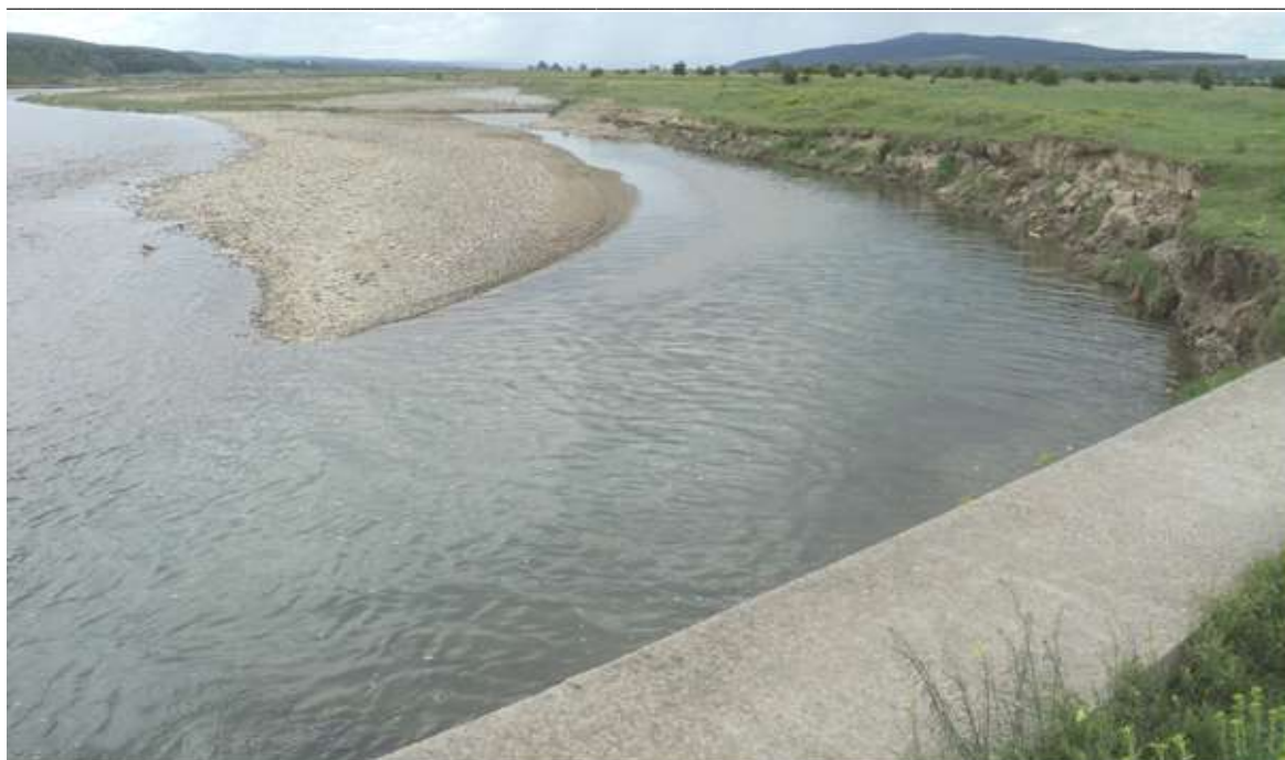
Foto - Râul Trotuș - zona de incastrare amonte a apararii de mal - salteaua apararii cu plasa de sarma deteriorata si fara umplutura din bolovani de rau
