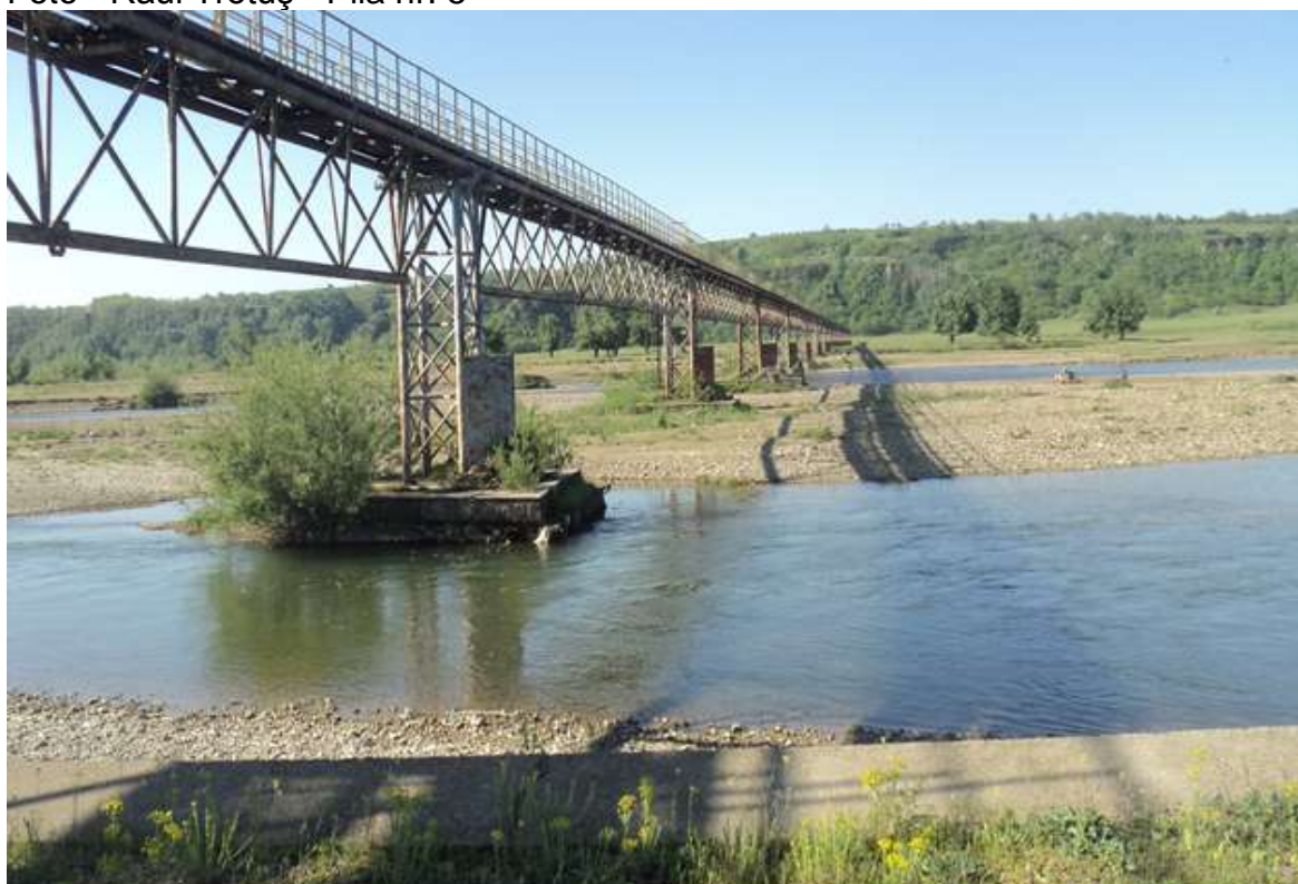
Foto - Vedere sectiune traversare râul Trotuș-Pila nr. 2 – consolidare pila, Rau Trotus - Pila nr. 2 - consolidare pila, deteriorata
