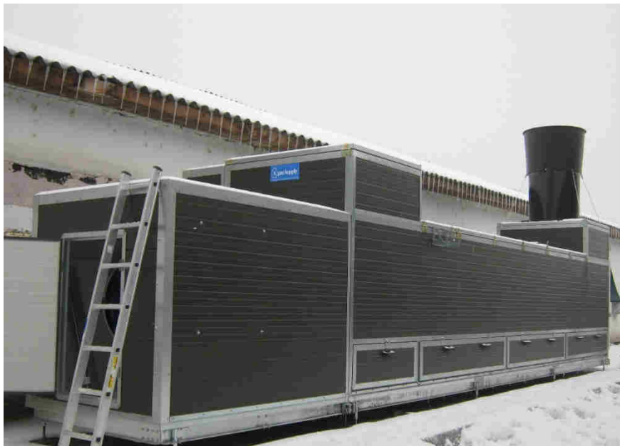
Recuperatorul de căldură
