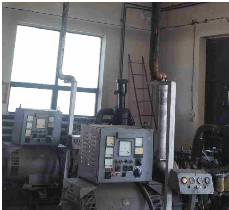
Figura nr. 7. Generatoare electrice
