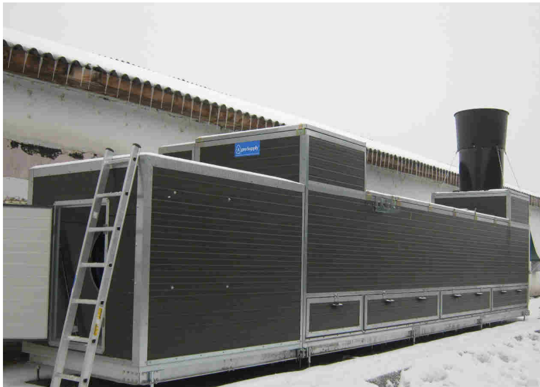
Figura nr. 11. Recuperatorul de căldură
