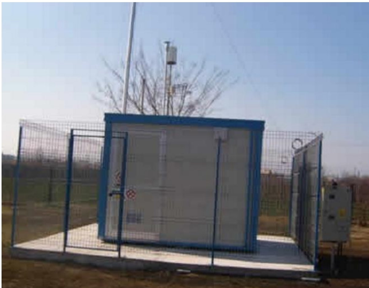
Figura nr. 2-11- Stația de fond regional VN 1, Str. Șoseaua Suraia
