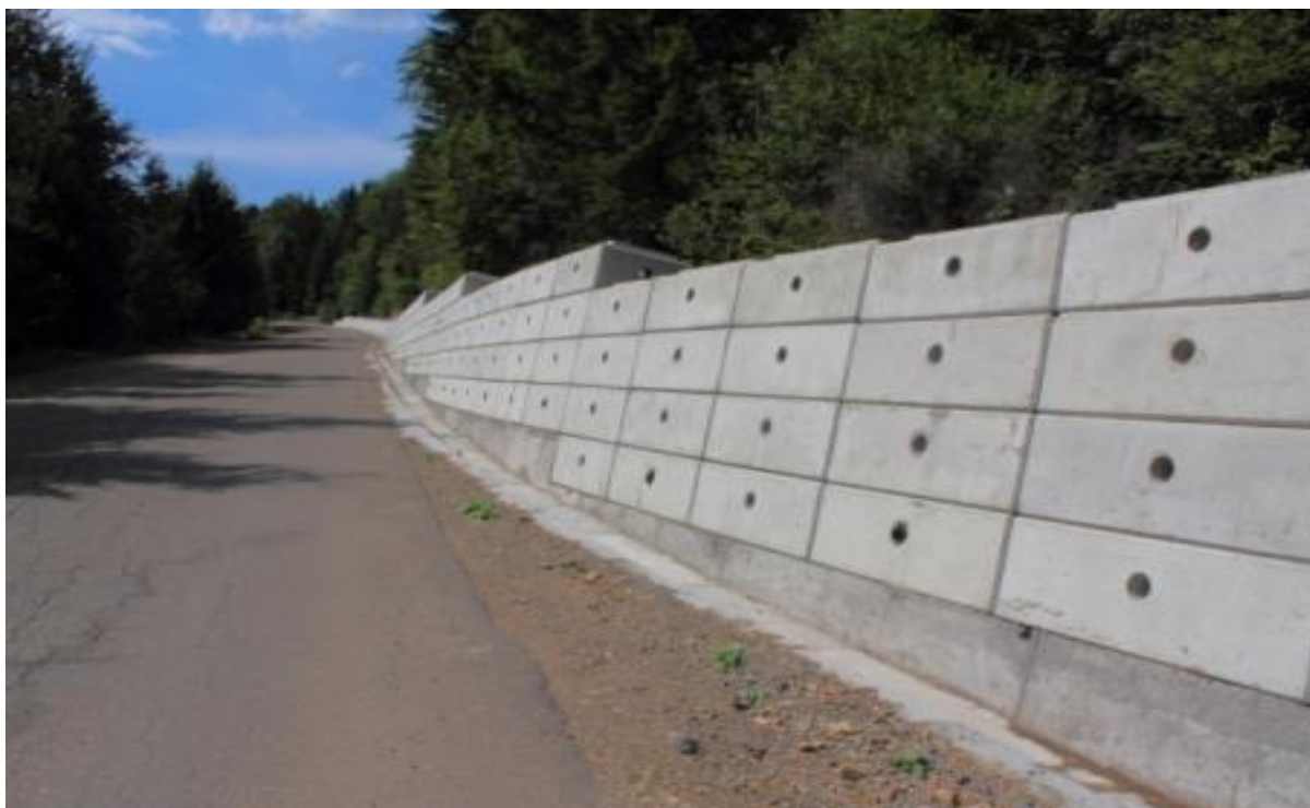
Fig.V.1.4.2.3. Parapet din beton lângă DN 2D, barieră absolută pentru lup
