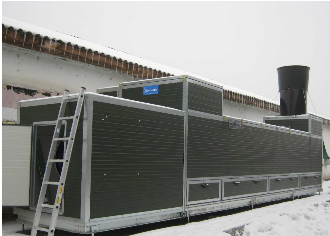
Figura nr. 11. Recuperatorul de căldură
