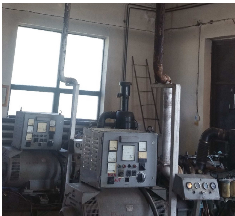
Figura nr. 7. Generatoare electrice
